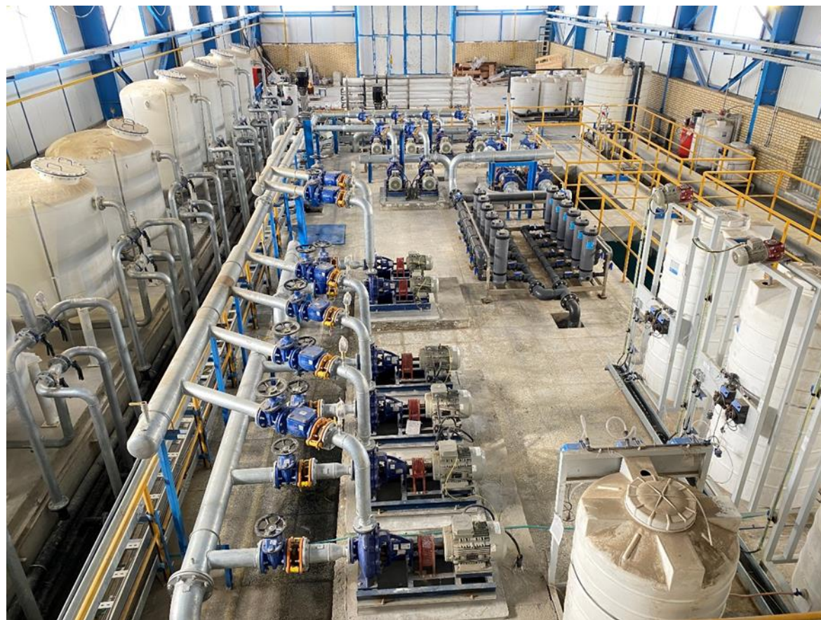
پروژه تصفیه آب فولاد خيام نيشابور (پيش تصفيه و اسمز معكوس)، كارفرما: فولاد خيام نيشابور، سال بهره برداري يك ۱۴۰۲، ظرفيت: ۴۰۰۰ متر مكعب در شبانه روز (تصاویر پروژه اجرا شده)
