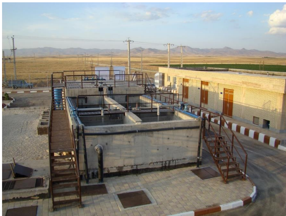
پروژه اجرای عملیات احداث و راهبری یکساله تصفیه خانه فاضلاب شهرک صنعتی رزن-همدان، مشاور طرح، مهندسین مشاور پدید آب سپاهان، مدت پیمان: ۱۵ ماه، سال اجرا: ۱۳۹۱
